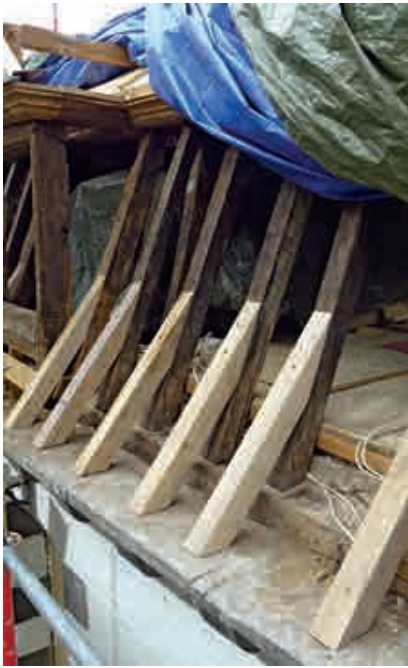
Fig. 15.- Volume central. Détail du brisis après remplacement des chevrons du coyau. Les chevrons conservés s'appuient sur la sablière et sont encastrés, vers le haut, dans le membron. Trace d'une encoche dans la sablière, indice que les chevrons n'occupent pas leur emplacement d'origine.
