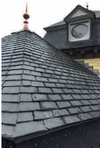
Fig. 28.- Détail d'un arêtier de l'aile sud avec alternance des recouvrements des extrémités des ardoises. © Gérard Bavay.
