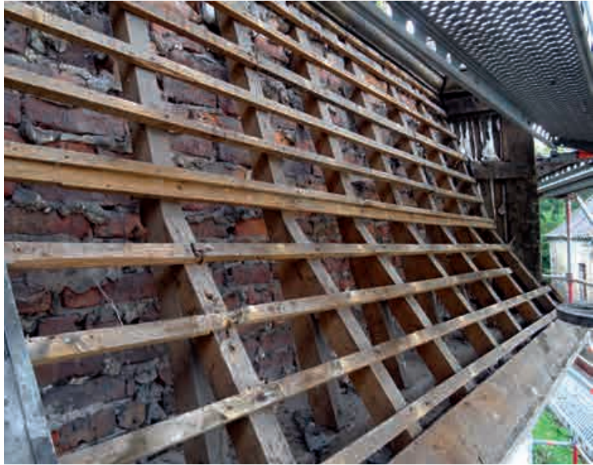
Fig. 13.- Brisis de l'aile méridionale. Le lattage est fixé directement sur le chevronnage tardif. Une maçonnerie double le brisis. © Gérard Bavay.
