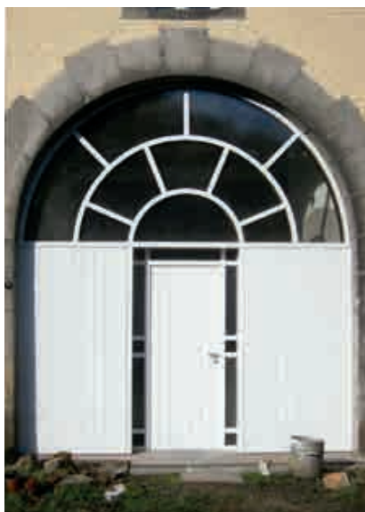
Fig. 8. - Châssis établi dans la porte cochère en 1992 (côté intérieur de l'abbaye). © Gérard Bavay.
