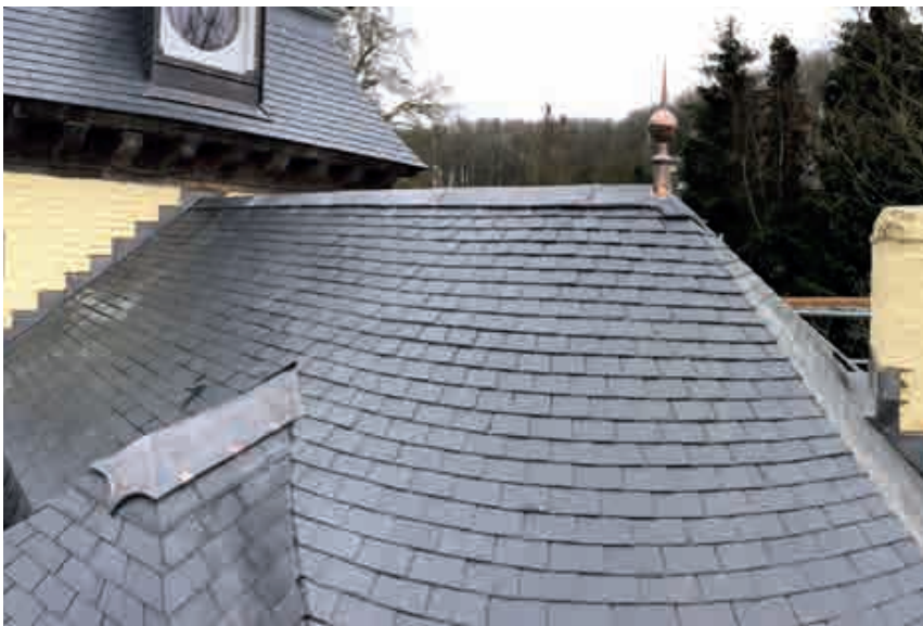
Fig. 38.- Aile sud. État final de la surface voilée du terrasson. © Thierry Le Bihan.
