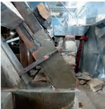
Fig. 12.- Réparation à la résine de l'extrémité d'un entrait. © Architectes associés s.a., société civile d'architectes.
