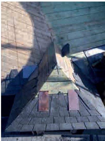
Fig. 33.- Couverture d'une lucarne. Les plaques de cuivre ne seront pas visibles. Elles constituent une sécurité supplémentaire à l'égard des possibles infiltrations. © Thierry Le Bihan.
