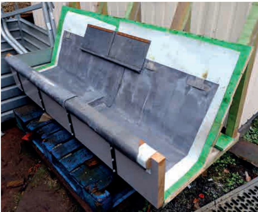
Fig. 15.- Maquette à l'échelle 1/1 : réalisation d'un chéneau en plomb pour la corniche sud du vaisseau principal. © Architectes associés s.a., société civile d'architectes.
