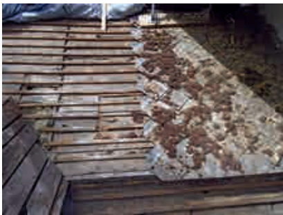
Fig.10.- État avant restauration: ardoisage en asbeste-ciment, lattage et voligeage. © Gérard Bavay.
