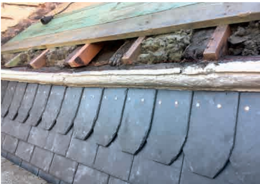
Fig. 20.- Pose de la dernière ardoise fixée à deux clous sous le membron de la toiture.
