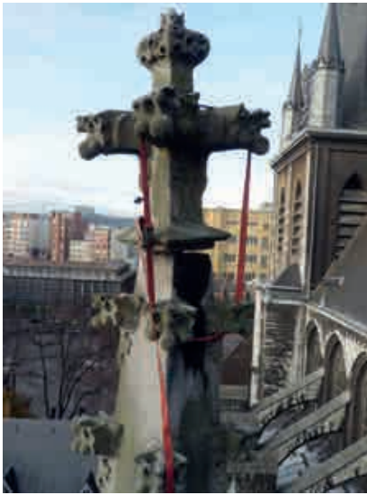
Fig. 5.- La corrosion du goujon de liaison entre le pinacle et le fleuron a créé l'instabilité de celui-ci. © Architectes associés s.a., société civile d'architectes.
