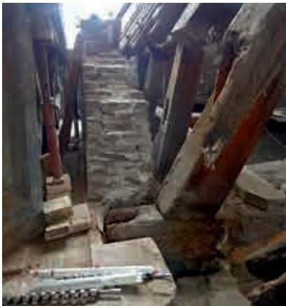
Fig. 11.- Extrémité d'entrait dégradé par l'humidité contenue dans les maçonneries. © Architectes associés s.a., société civile d'architectes.
